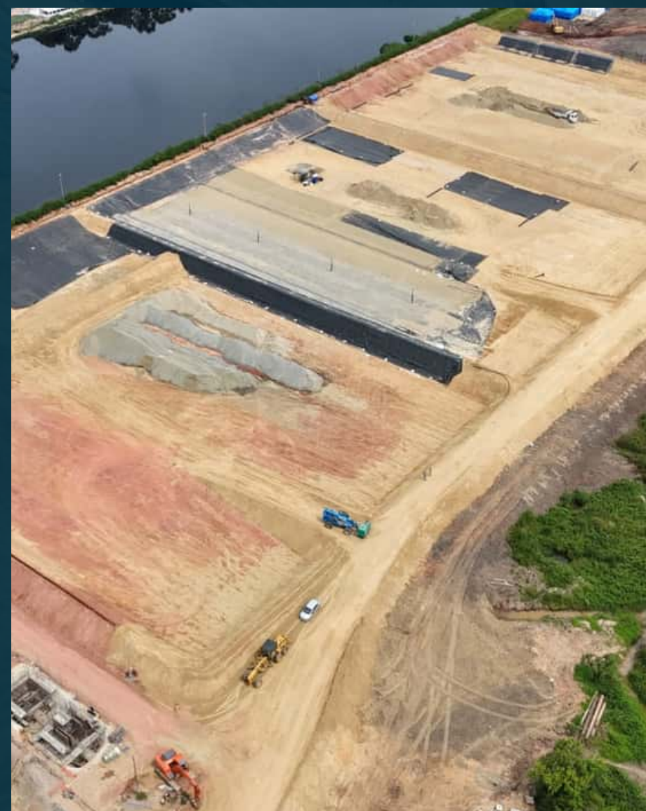
GOETZE LOBATO ENGENHARIA ETE CIC XISTO – CURITIBA – PR
